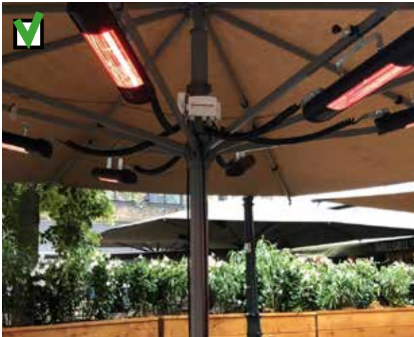
Parasolverwarming, indien mogelijk met bekabeling
